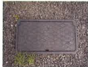
水道メーター
