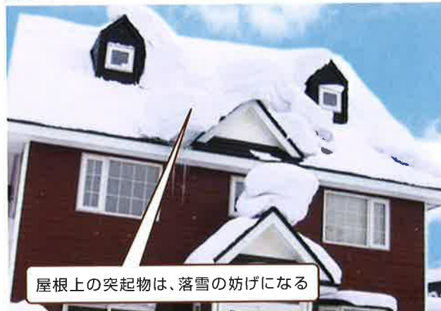
■写真:2 複雑な屋根形状での落雪障害
