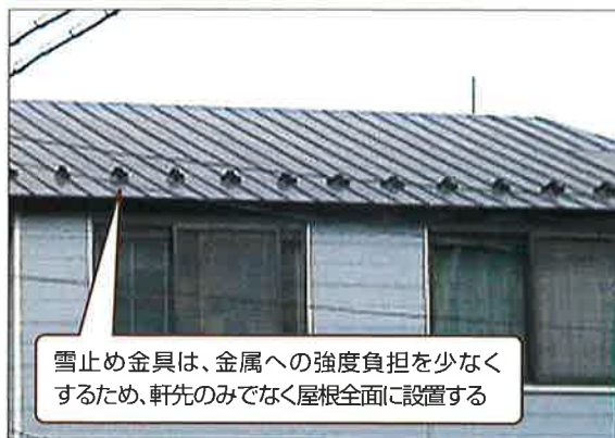
■写真:4 不適切な雪止め金具の設置状況
