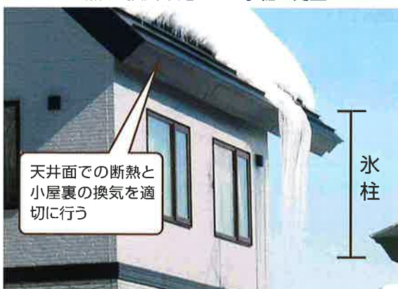
■写真:5 断熱と換気不足による氷柱の発生
